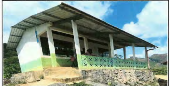
Foto 4: Se observa la necesidad de pintura en muros exteriores e interiores del aula.
